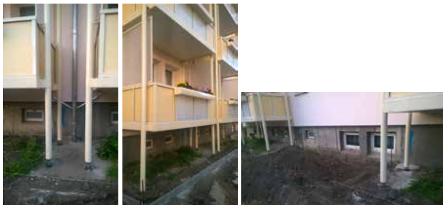
Figura 2 – Fachadas transformadas com instalação de varandas metálicas, cuja estrutura invade a área de circulação. Dessau (ALE), 2015. Invasão discreta, mudança incontestável. Fonte: acervo da autora
